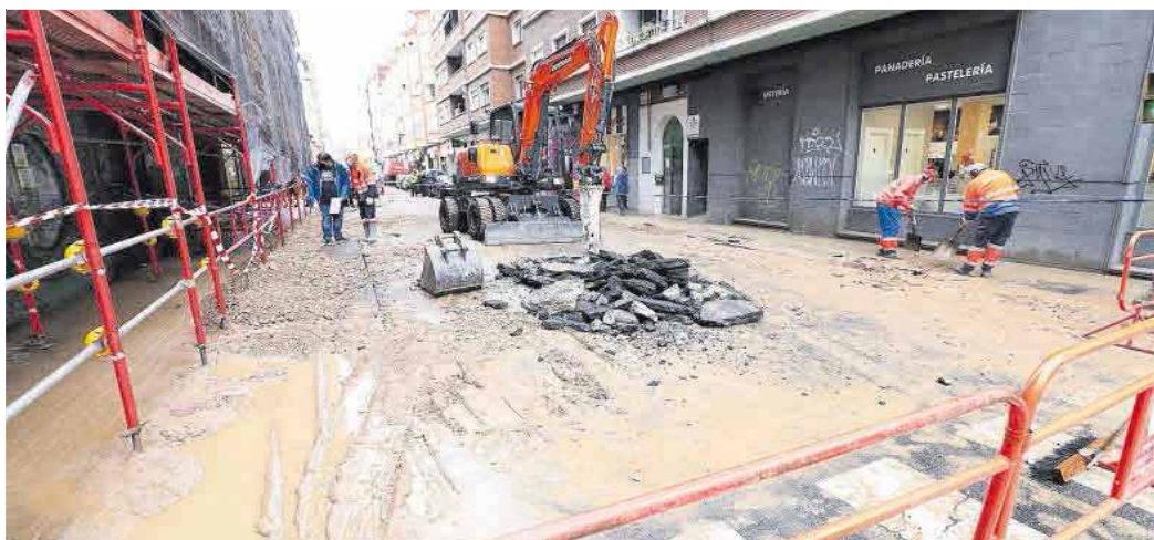
Operarios trabajando tras un reventón de una tubería en la calle Félix Latassa de Zaragoza, en una imagen de archivo.
