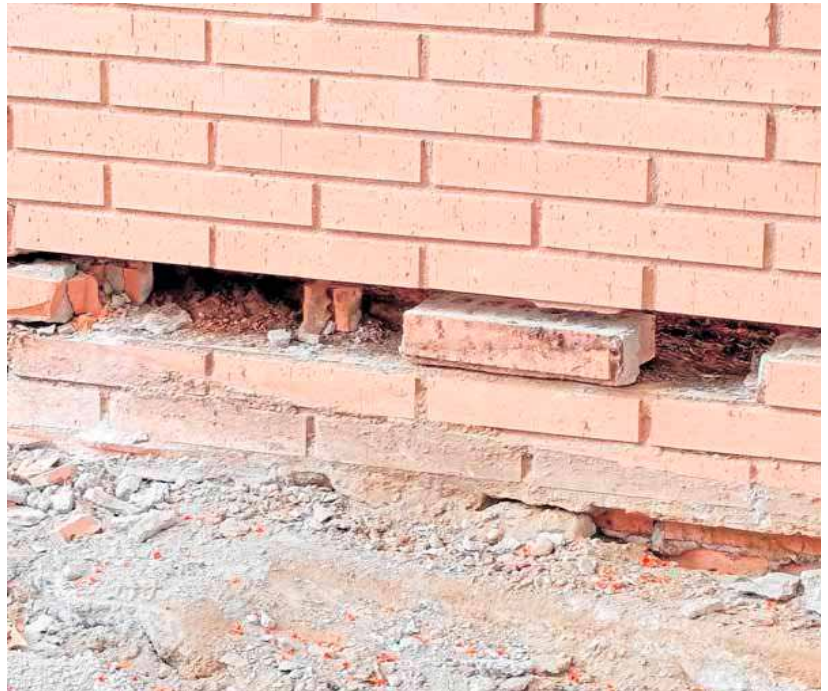
Los ladrillos de las fachadas llevan tiempo resquebrajados. R. I.
