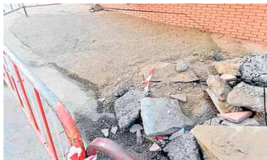
Los escombros se adueñan de la acera. R. I.
